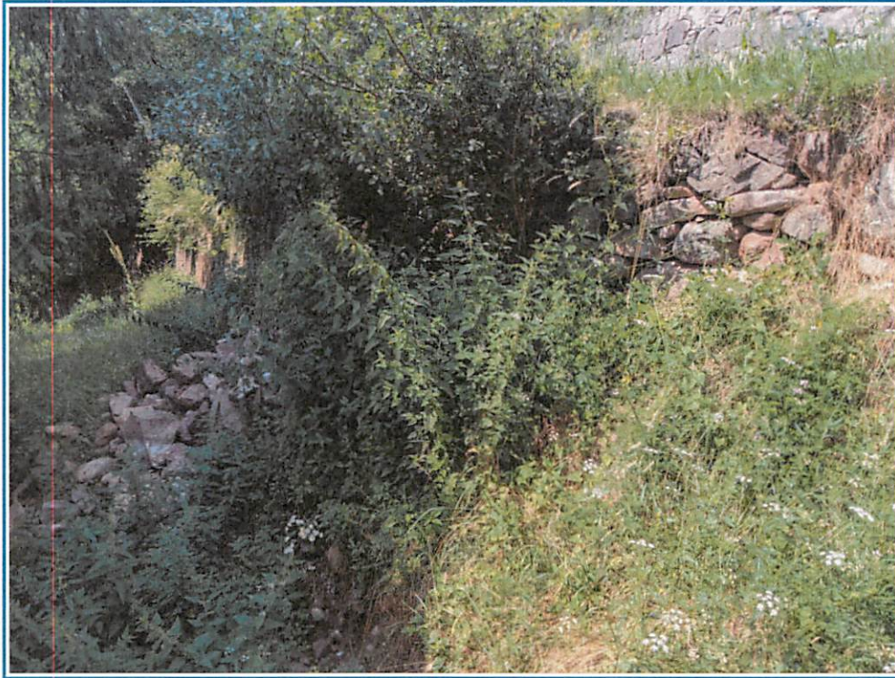
Foto 3: Vista del crollo dalla sottostante strada rurale.
