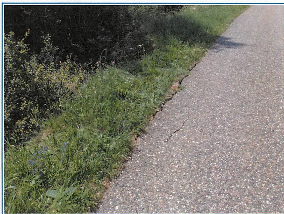
Foto 2: Particolare dell'incrinatura tra la pavimentazione stradale e la banchina.
