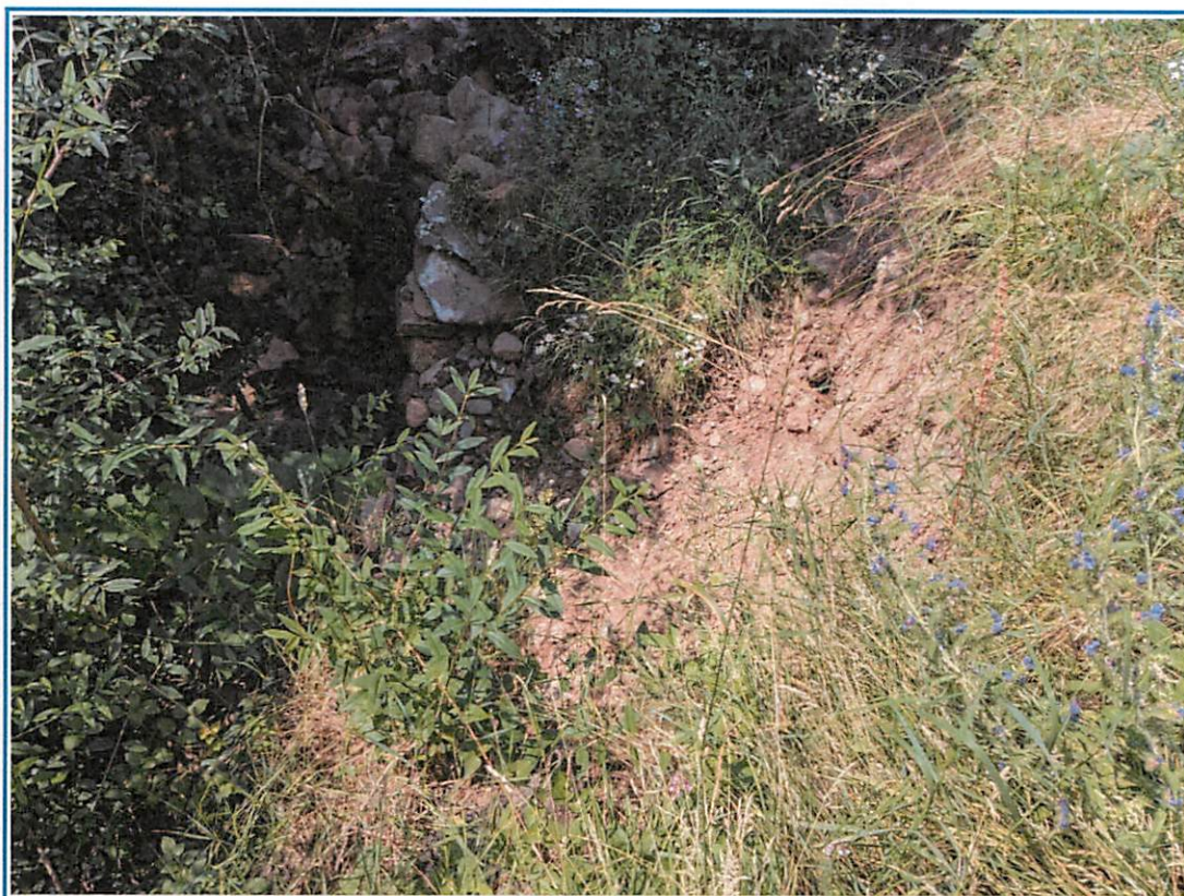
Foto 5: Particolare del cedimento del rilevato stradale della strada rurale sottostante.
